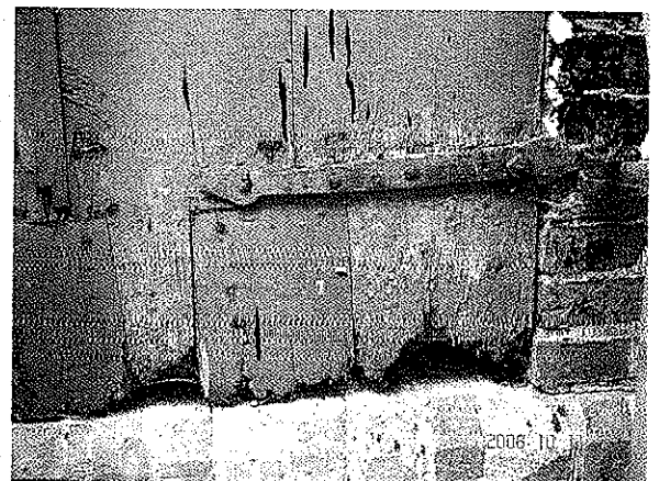
ZDJĘCIE NR 30 Uszkodzone drzwi do lamusa przez grzyb piwniczny oraz owada kolatka domowego
