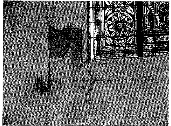
ZDJĘCIE NR 20 Ściana w absydzie. Uszkodzenie tynku spowodowane zagrzybieniem drewnianej konstrukcji szkieletowej ścian.
