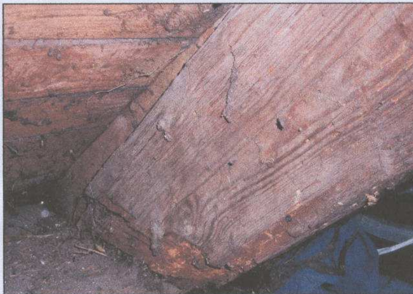
Dół krokwi – widoczne kanały owadzie. Niezrozumiałe obrabianie dołu krokwi – prawdopodobnie ślad po usuniętych fragmentach spróchniałego drewna (rozkład brunatny)
