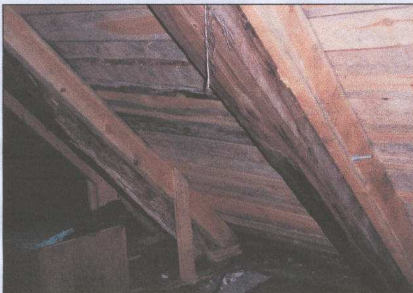
Zaawansowana destrukcja drewna konstrukcyjnego „naprawiona” poprzez nabicie bali nieimpregnowanych. Widoczne nowe deskowanie z drewna nieokorowanego.
