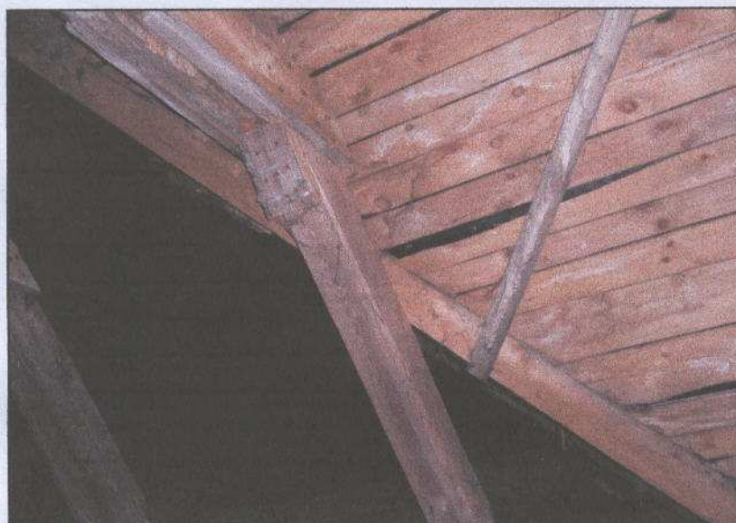
Wymieniona belka koszowa „wzmocniona” starą deską. Widoczne wykwitły impregnatu solnego.
