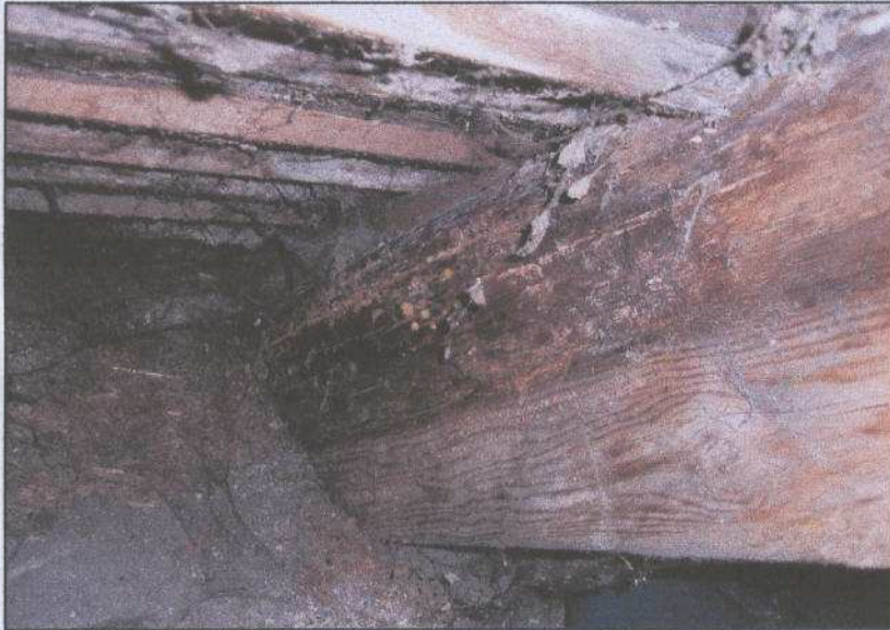
Dolny fragment krokwi opartej na obetonowanym murłacie. Widoczny powierzchniowy rozkład brunatny drewna.
