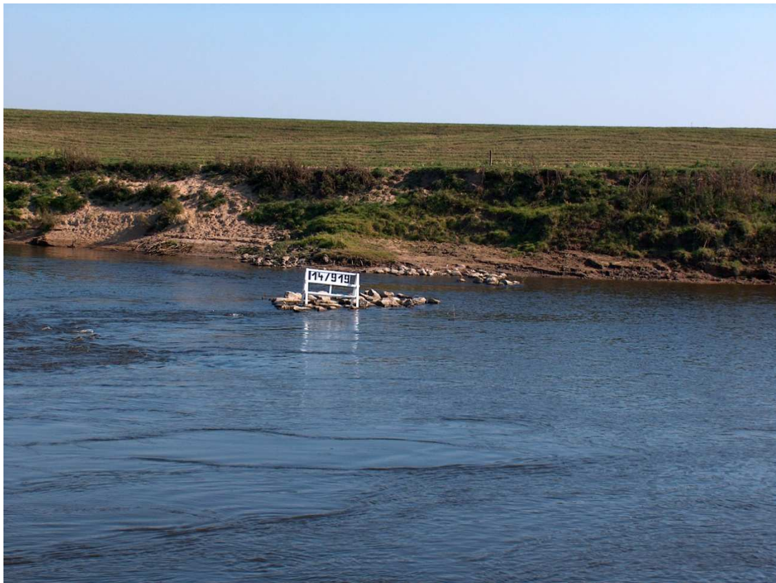
Fot. 28. Ostroga nr 14/919 – gmina Ostaszewo Źródło: RZGW
