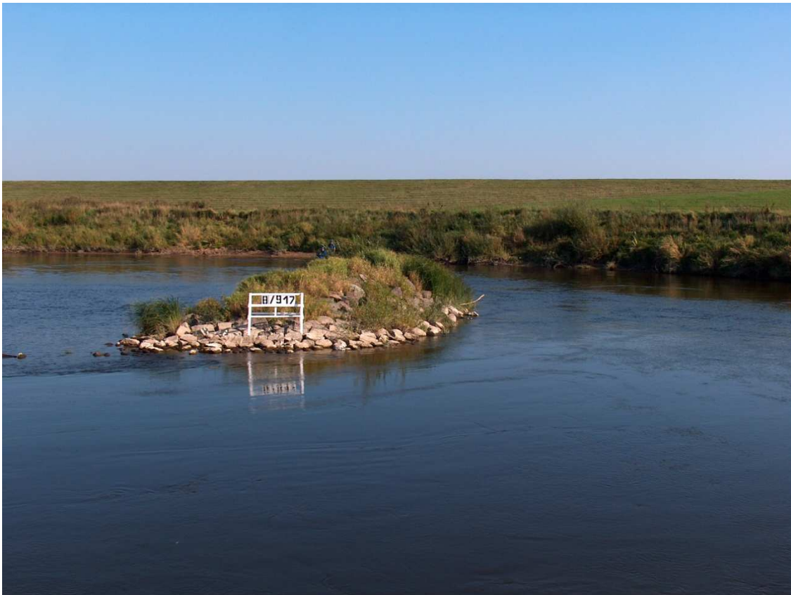
Fot. 24. Ostroga nr 8/917 – gmina Ostaszewo Źródło: RZGW
