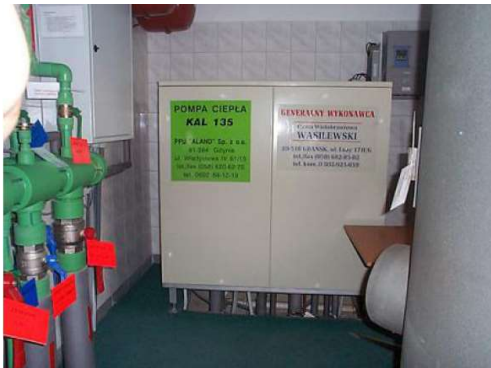
Zdjęcie 11. Pompa ciepła zainstalowana w szkole podstawowej w Cedrach Wielkich
