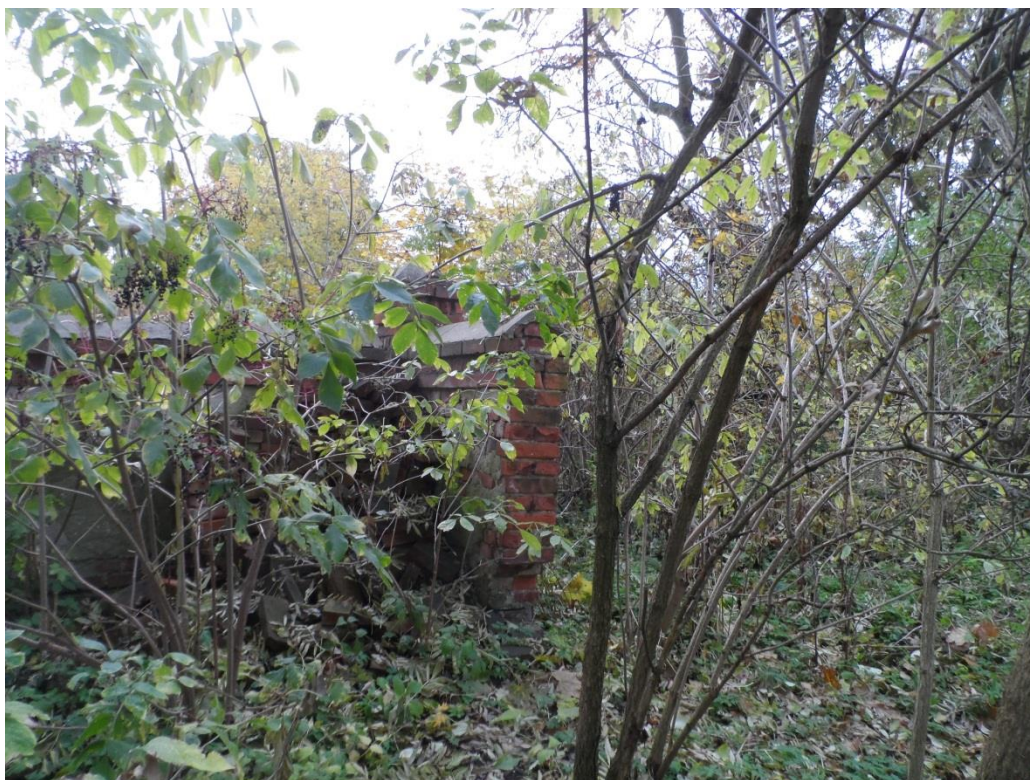
Narożnik południowo – wschodni – na długości 5 przęseł ogrodzenie całkowicie zburzone
