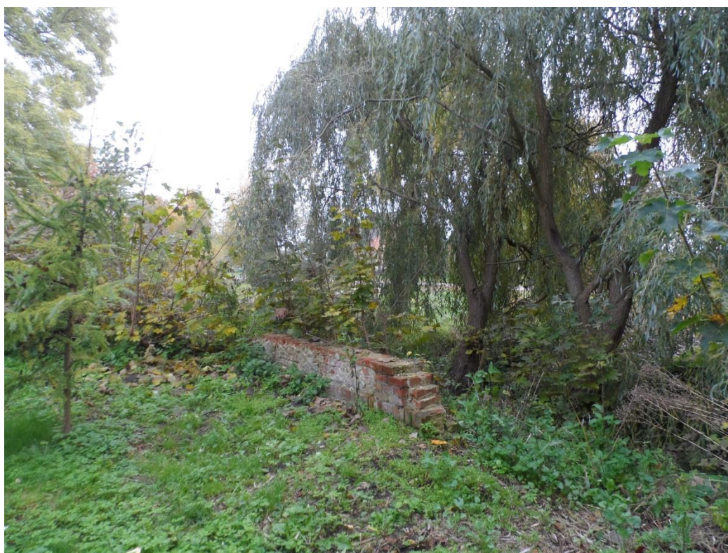
Część północna ogrodzenia wschodniego – całkowicie wyburzona
