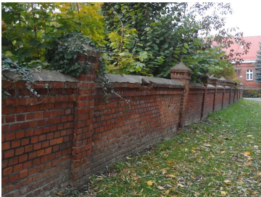
Część północna ogrodzenia – mur znacząco odchylony od pionu
